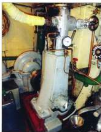
Ångmaskinen som driver cirkulationspumpen står på bakhjulsidan bredvid kondensorn. Foto Ingvar Kronhamn
